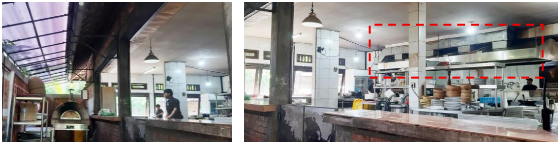
Gambar 7. Pengendalian kualitas udara pada area dapur Sumber: Penulis, 2026
